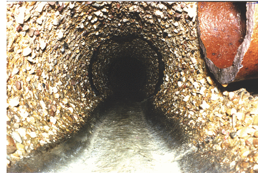
Corrosión biogénica después de solamente 15 años en Alemania. Red unitaria, aguas residuales domesticas.
