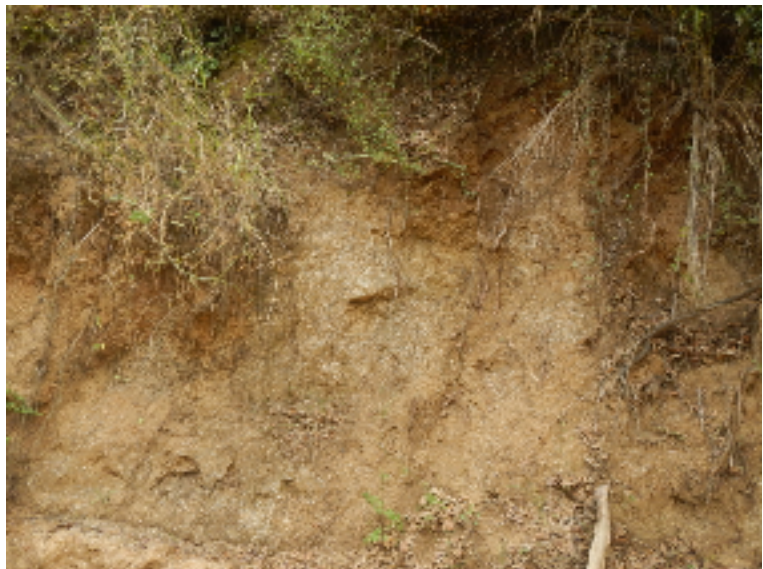
Foto 24: Detall de talús amb risc d'erosió al marge dret de la Travessia dels Eucaliptus (Font: MCA Consultors)
