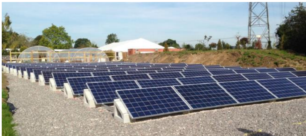
Figura 15. Exemple de panells col·locats sobre estructures SolarBloc
