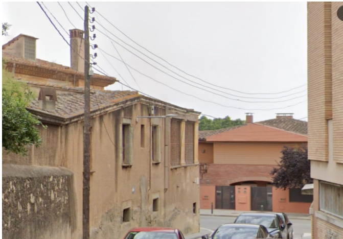
Cables elèctrics al carrer Sant Joan, 16
