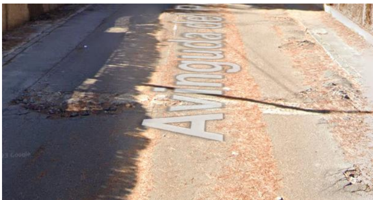
Forats al paviment de l'avinguda del Puntó, 14
