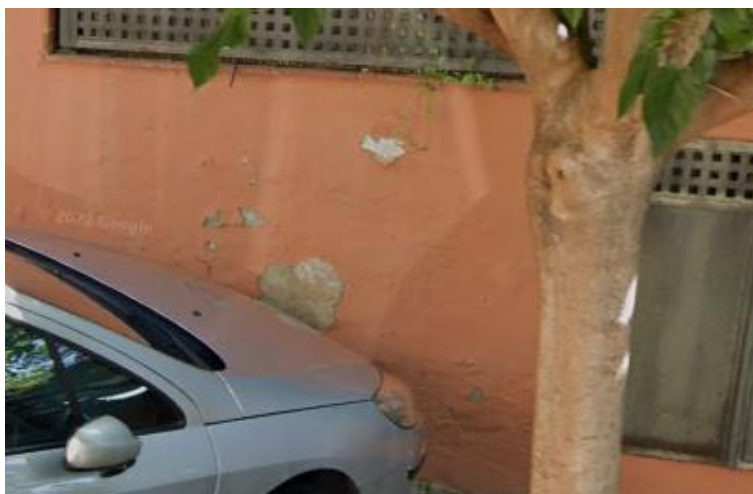
Desperfectes als murs de finques privades al passeig de les Moreres, 1
