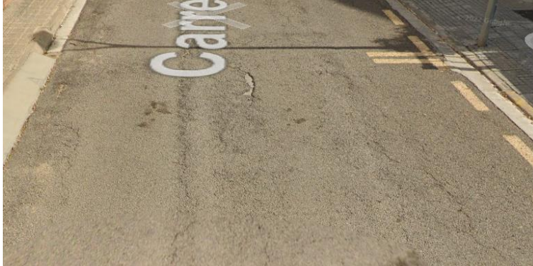
Forat a l'asfaltatge al nivell del carrer Garbí, 2
