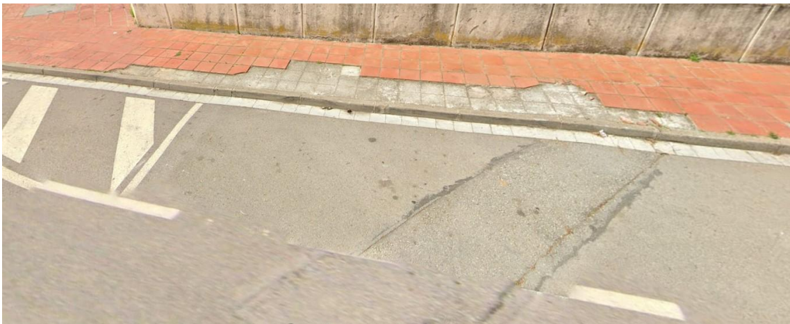
Vorera en mal estat al Carrer de l'Alzina
