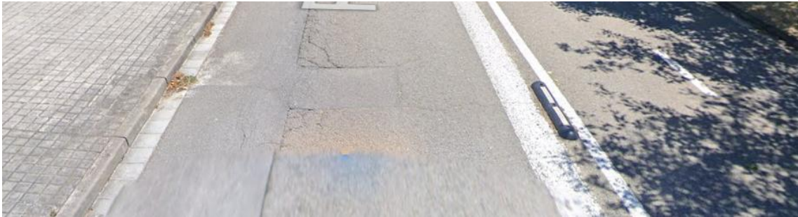
Ferm en mal estat al Passeig de la Riera
