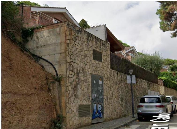
Estació transformadora d'Endesa en mal estat. Font: Google Street View.
