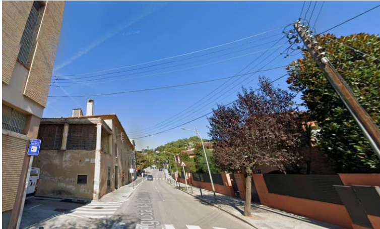
Cablejat elèctric que baixa a Av. Catalunya amb Carrer Sant Joan.
