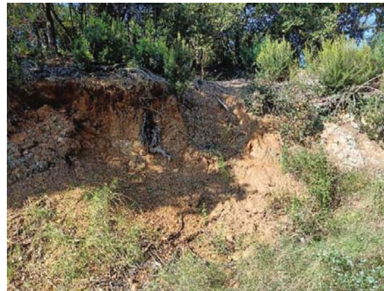
Fotografia índex 8. Talús de desmunt en sòls d'alteració de la roca. Lliscaments de magnitud petita. Carrer del Montseny
