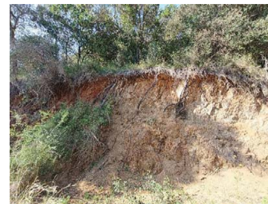
Fotografia indicati 5. Talús de desmunt en sòls d'alteració de la roca. Caiguda de blocs i lliscaments de magnitud petita. Carrer del Canigó
