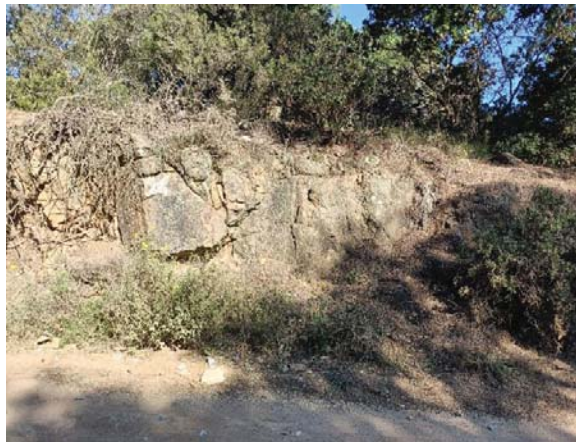
Fotografia índex 7. Talús de desmunt en sòls d'alteració de la roca. Caiguda de blocs i lliscaments de magnitud petita.AVINGUDA de la Cornisa.
