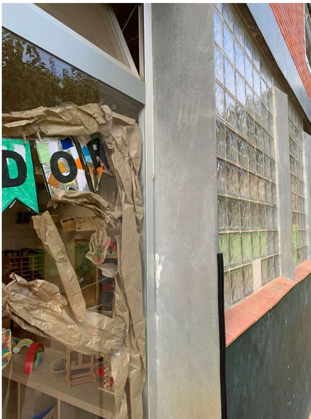
Imatge 02; Façana Nord- Trobada entre mur i fusteria existent.
